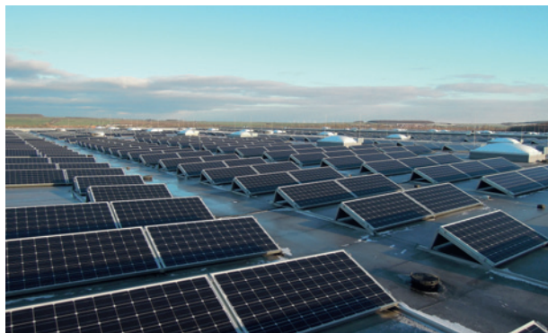
Installation Motex de 1039 kW à Hørselgau
